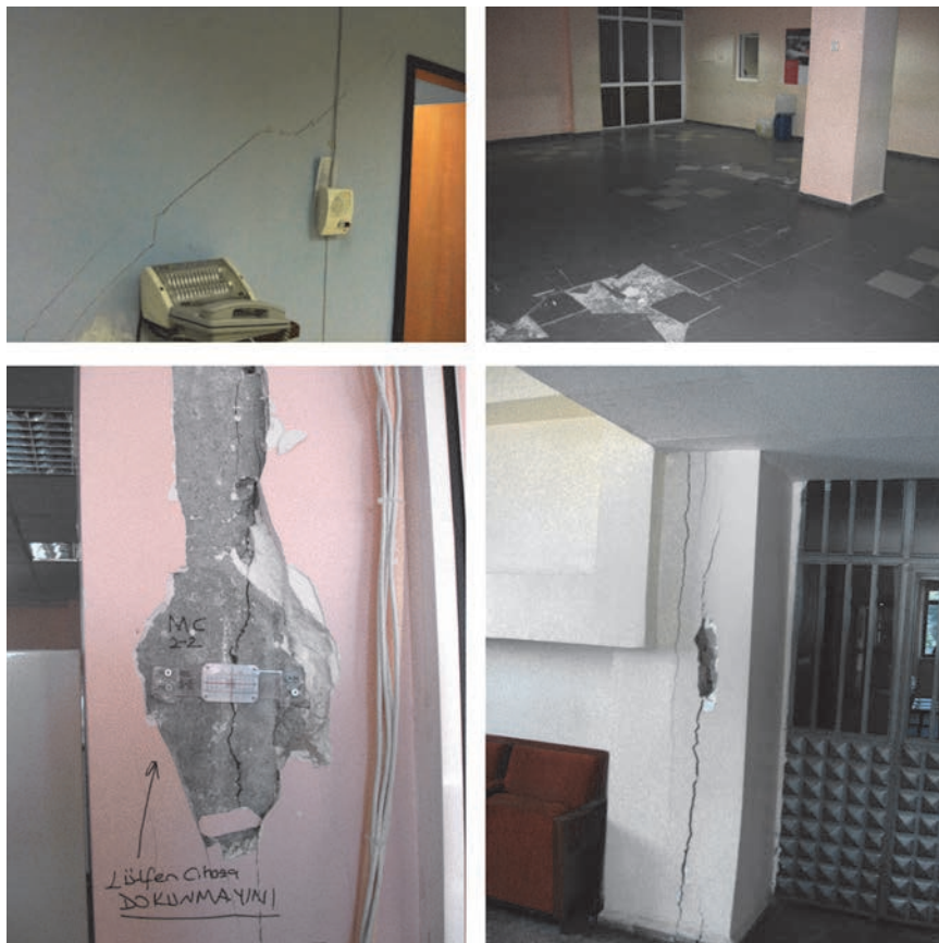
Slika 6. Pukotine na nosivim i nenosivim elementima
