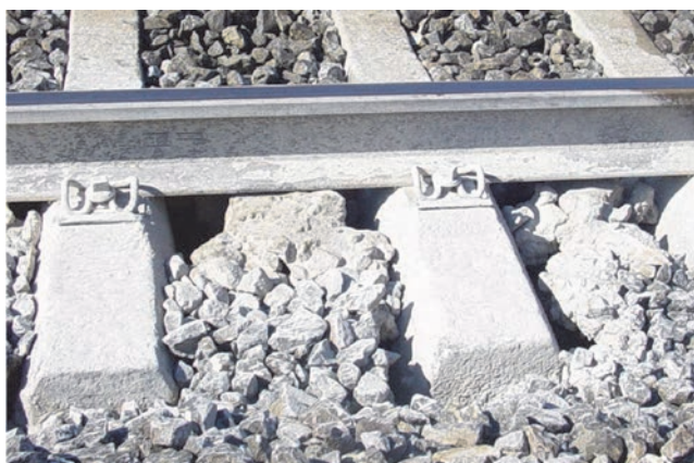
Slika 11. Sustav za nadzor površinskih oštećenja kolosijeka – detekcija "prskavaca" (zablačenja) i nestabilnih pragova
