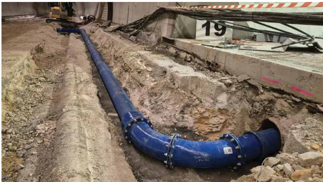
Tlačni cjevovod u tunelu Učka
