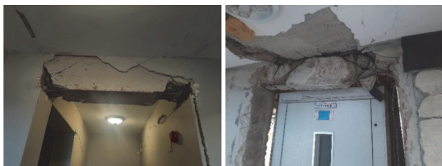
Slika 23. Primjeri pukotina na kratkim gredama spojenih s posmičnim zidovima dizala
