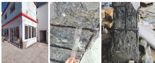
Slika 17. Konstrukcijska oštećenja u višekatnoj zgradi u pokrajini Hatay nakon potresa
