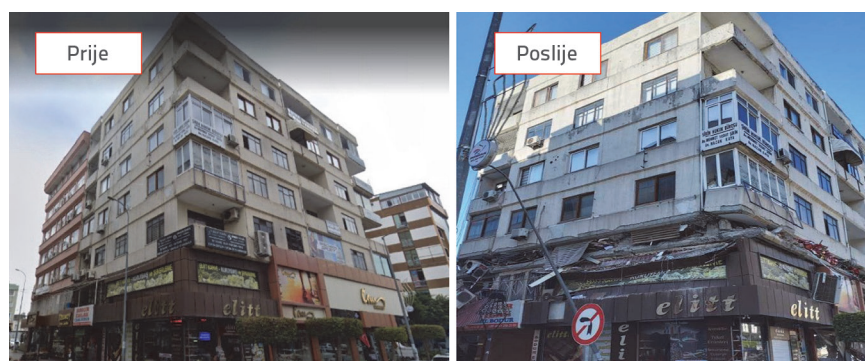
Slika 15. Konstrukcijska oštećenja prije potresa u İskenderunu, u pokrajini Hatay, i nakon njega
