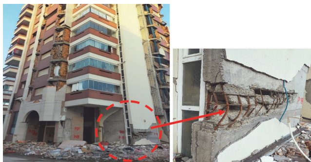
Slika 19. Plastična deformacija i oštećenja uslijed savijanja izvan ravnine u posmičnome zidu u Iskenderunu (Hatay)
