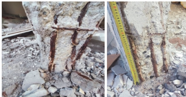
Slika 18. Gubitak prionjivosti armature u betonu i smanjenje promjera armature (smanjenje poprečnog presjeka)
