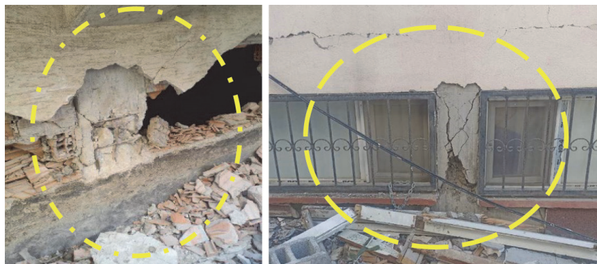
Slika 14. Oštećenja uzrokovana konstrukcijskim nepravilnostima kratkih stupova u Antakiji, u pokrajini Hatay
