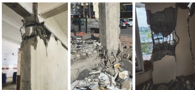
Slika 22. Loše izvedena poprečna armatura
