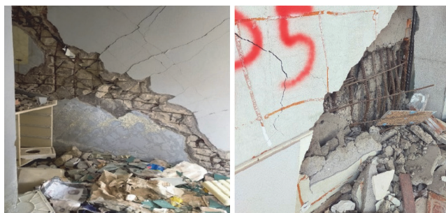
Slika 20. Dijagonalne pukotine i gubitak presjeka u nosivim zidovima
