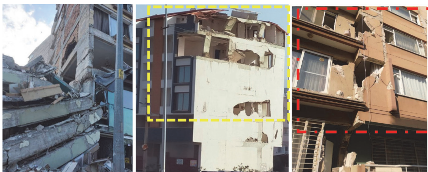
Slika 13. Građevine čiji su nosivi elementi oštećeni uslijed utjecaja susjednih građevina
