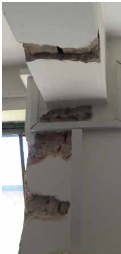
Pukotine na spoju stupa i grede
