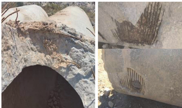
Slika 5. Raspuknuta PCCP cijev [6]
