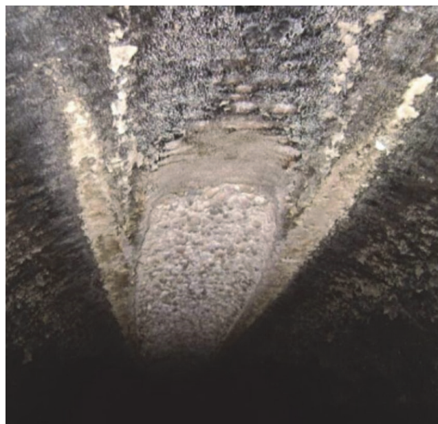
Slika 15. Površinska korozija i izloženi agregati [76]
