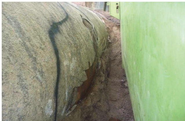
Slika 12. Početak loma cijevi promjera 96 inča [57]
