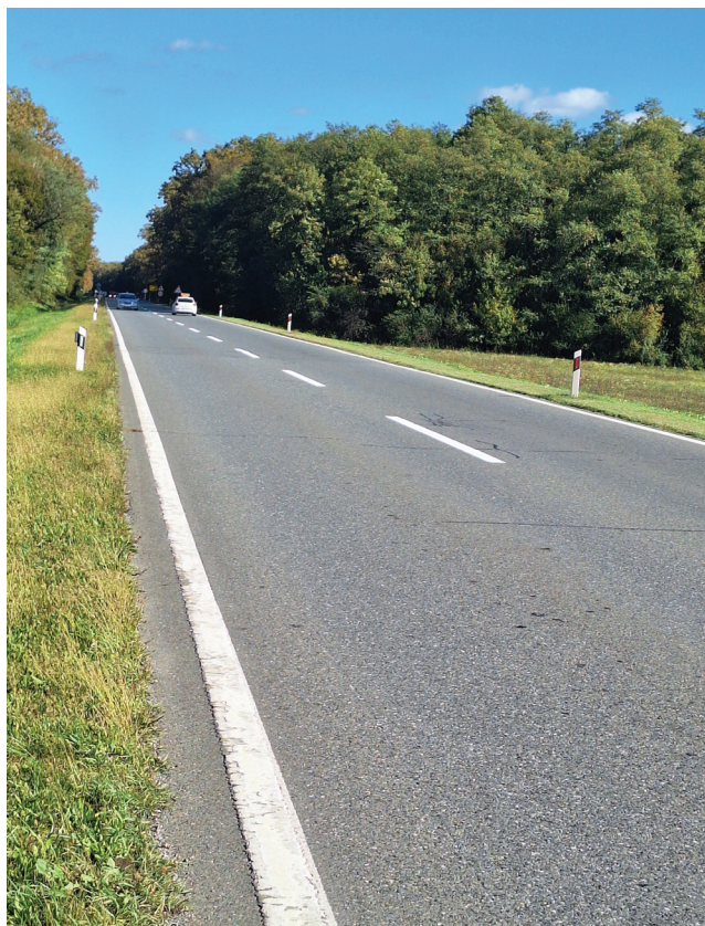
Slika 2. Strukturalne pukotine na D28, bjelovarskoj obilaznici, od km 0+800 do km 2+100
