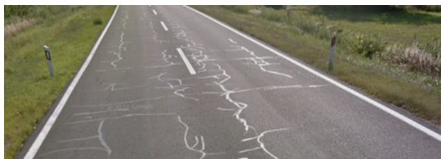
Slika 4. Temperaturne pukotine na D28, bjelovarskoj obilaznici, od km 7+000 do km 7+500
