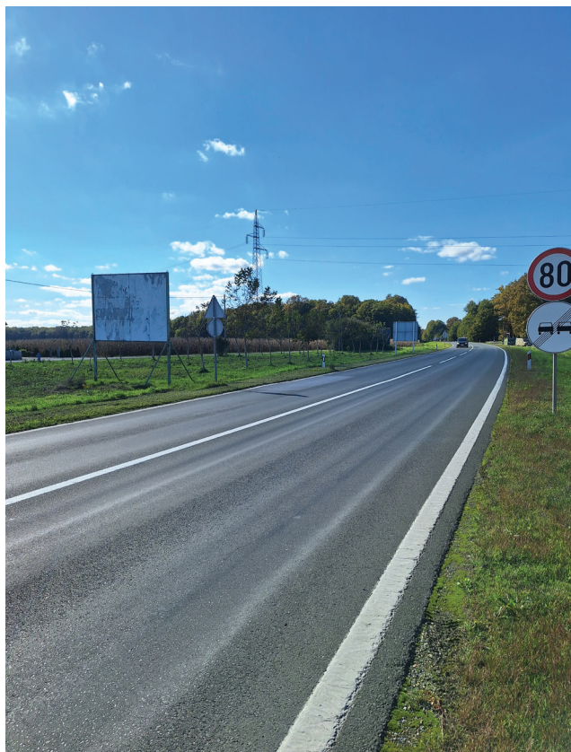
Slika 3. Kolotrasi na D28, bjelovarskoj obilaznici, od km 2+900 do km 3+300
