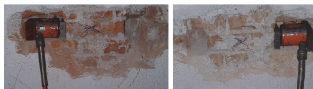
Hrvatski dom, Petrinja, Ulica Matije Gupca 2 Posmična čvrstoća zida- sklerometar [MPa]
