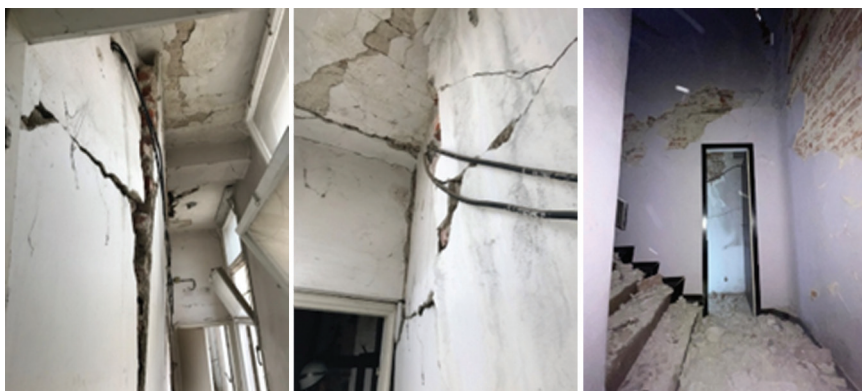
Slika 5. Stanje nenosivih i nosivih zidova uslijed gubitka stabilnosti izvan ravnine [3]
