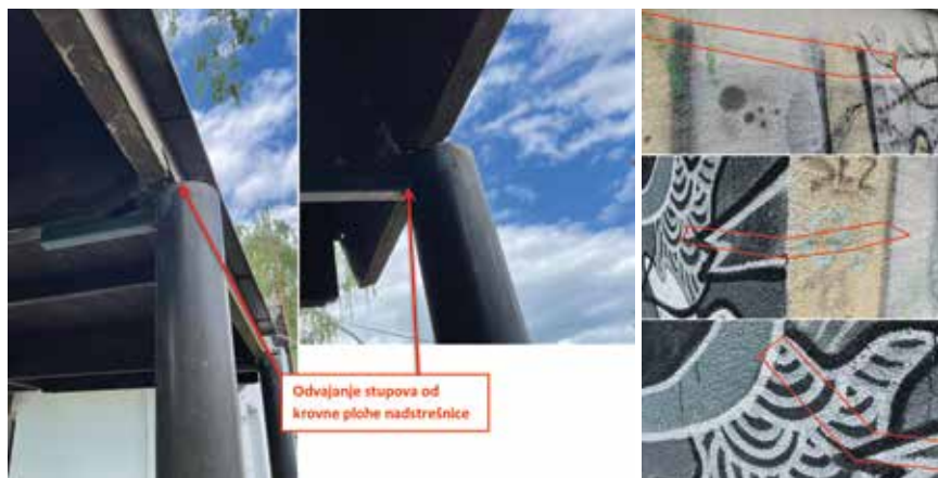
Oštećenja od potresa na zgradi Kazališta 21 (Foto: Elaborat ocjene postojećeg stanja)
