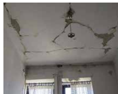
Pukotine u žbuci i odlamanje završnog sloja
