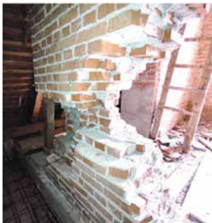
Teško oštećenje (neomeđenog!) opečnog zida zvonika iz obnove nakon Domovinskog rata
