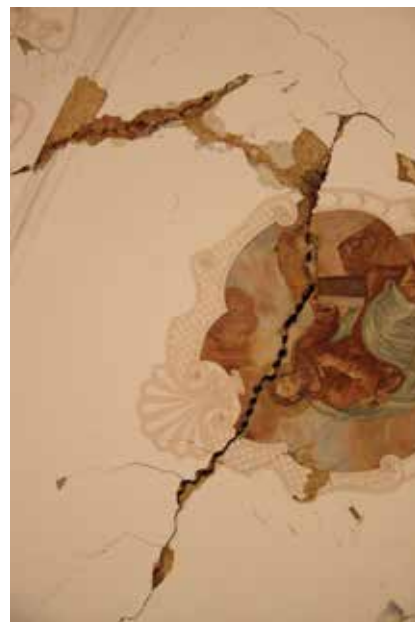
Teška oštećenja zidanog svoda
