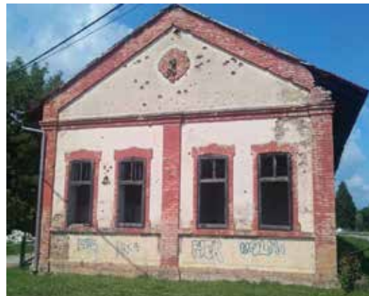
Oštećenja zgrade u vrijeme Domovinskog rata
