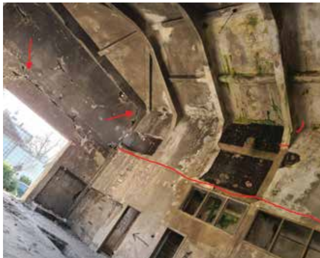
Odvajanje zabatnog zida i opća dotrajalost svih elemenata
