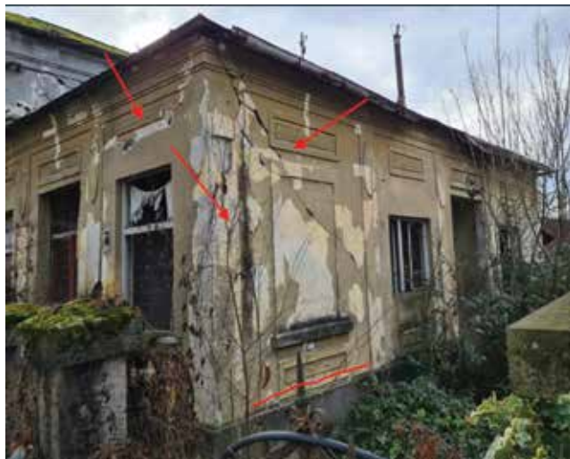
Pukotine na sjevernom pročelju zgrade A
