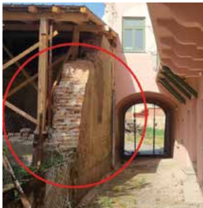
Urušeni nosivi zid od opeke
