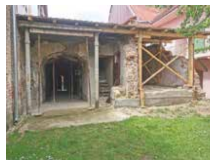
Dograđeni dio građevine u potresu je teško oštećen
