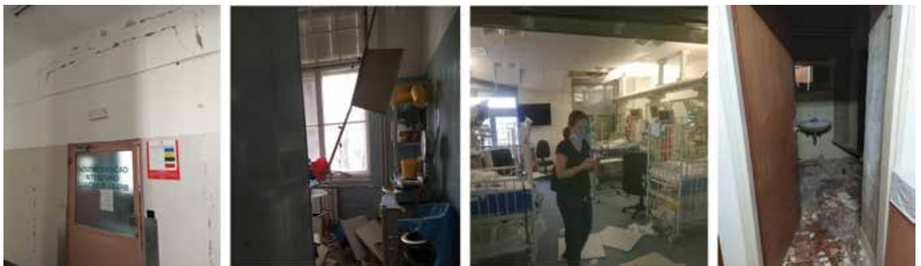
Zdravstvene ustanove oštećene u potresu (Foto: KBC Zagreb)
