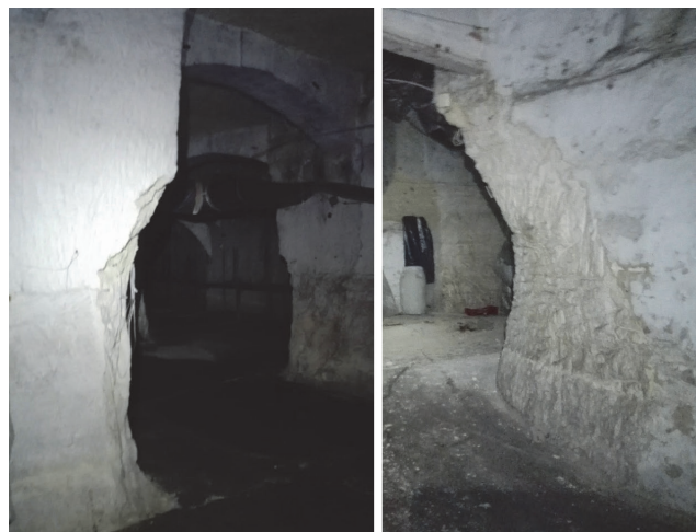
Slika 1. Usječeni segmenti stupova na ispitanoj području
