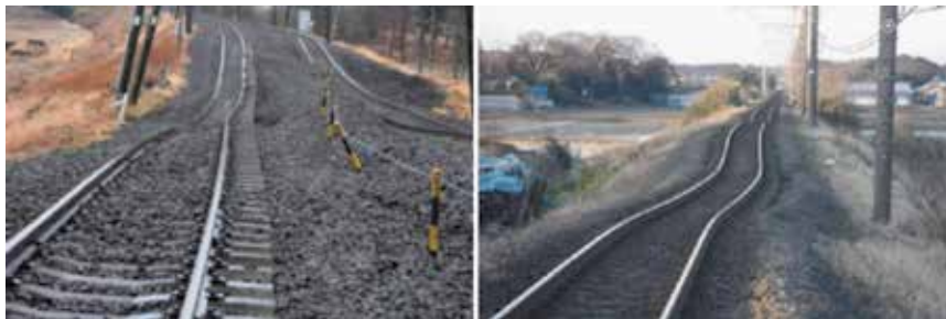
Slika 1. Primjer propadanja nasipa nakon potresa te njegova rekonstrukcija [7]
