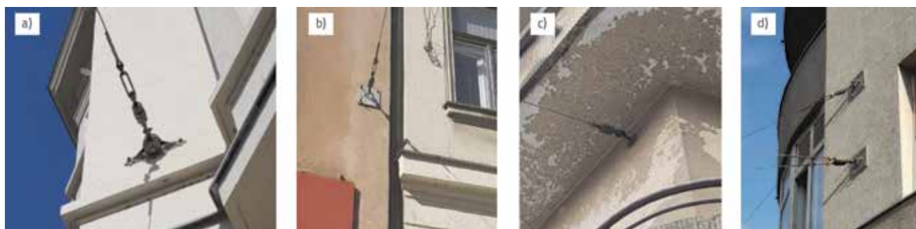
Slika 16. Prihvati kontaktne mreže: a) Ukrasna rozeta, b) Ploča sa 4 sidrena vijka, c) Kuka na sidrenom vijku, d) Prihvat više zatega na jednom pričvrstnom mjestu
