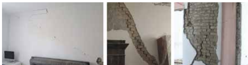
Slika 22. Dijagonalne pukotine u nosivim zidovima [39]
