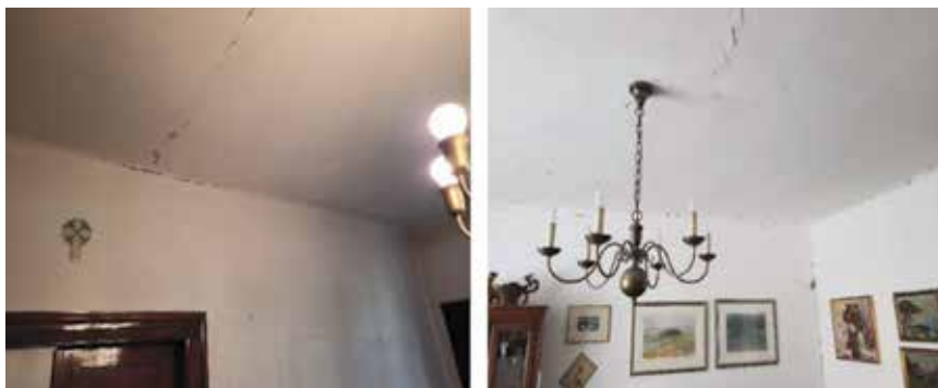
Slika 24. Pukotine na stropovima [39]
