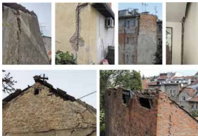
Slika 19. Odvajanje zabatnoga zida i karakteristične pukotine u unutarnjem dijelu zgrade (autor fotografija: Mario Todorčić [39])
