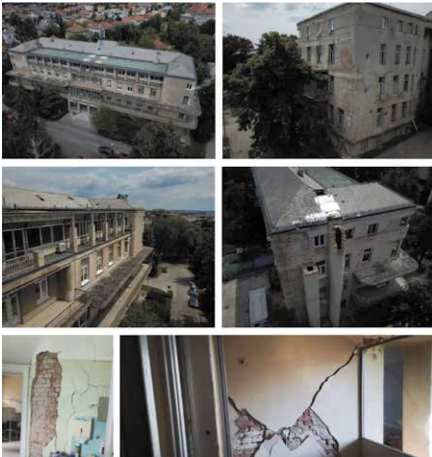
Slika 37. Prikaz oštećenja u zgradi Klinike za ortopediju na Šalati
