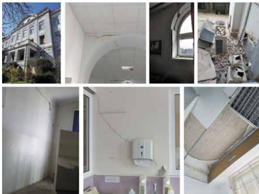
Slika 36. Oštećenja u staroj zgradi Klinike za ženske bolesti i porode u Petrovoj
