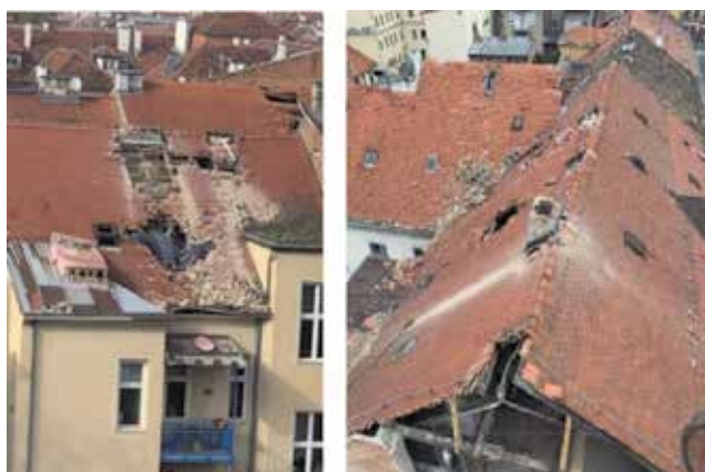
Slika 20. Oštećenja krovišta (autor fotografija: Mario Todorčić)
