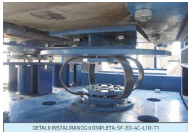
Slika 20. Izrađeni i instalirani komplet sastavljen od dva uređaja DSRSB i jednog uređaja SF-ED-4C-L1R-T1 na desnoj krajnjoj potpori ispitivanog modela prototipskog mosta
