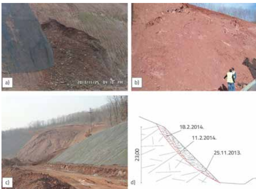
Slika 5. Slom na km 22+850: a) 25. studenoga 2013.; b) 11. veljače 2014.; c) 18. veljače 2014.; d) Model razvoja sloma
