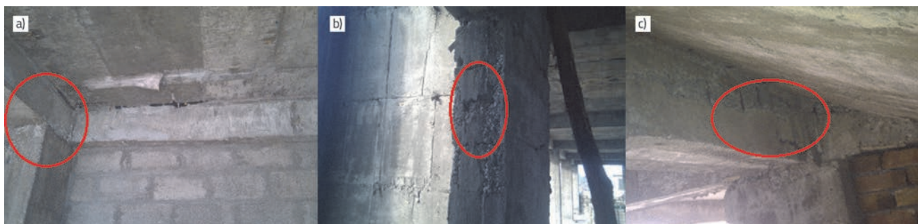
Slika 1. a) neodgovarajući spoj stupa i grede; b) građevni materijal loše kvalitete; c) nezaštićena armatura u blizini spoja između grede i stupa
