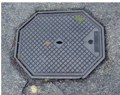
Poklopac vodovodne komore (s ključem)
