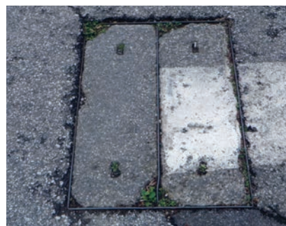
Betonski poklopac koji ne "lupa"
