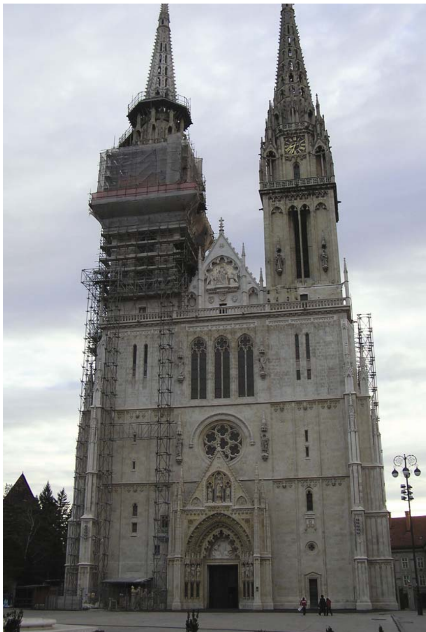
Obnovljeni portal Zagrebačke katedrale
