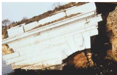
Slika 8. Detalj srušenog krila s oblogom od kamena i zidovima od opeke
