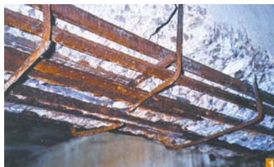
Slika 1. Pogled na oštećenu armaturu nakon uklanjanja kontaminiranog betona
